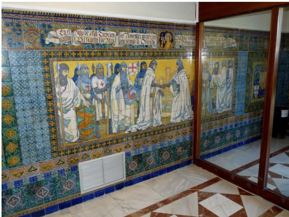
Perspectiva del segundo panel mutilado por un acristalamiento y una salida de ventilación
