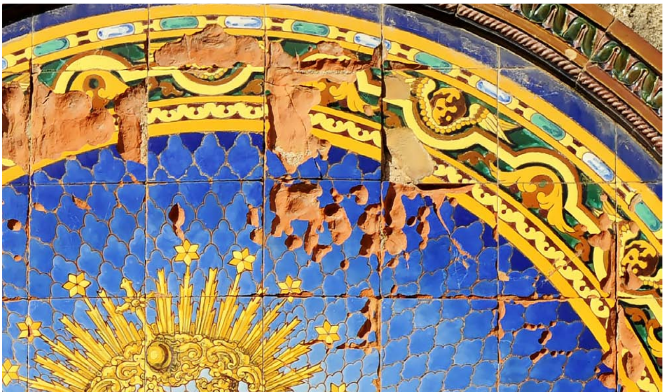
Coqueras, oquedades y pérdidas de pasta cerámica.
