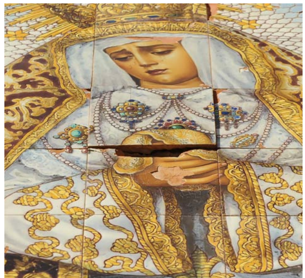
Detalle de las piezas desprendidas que amenazan con caer.
