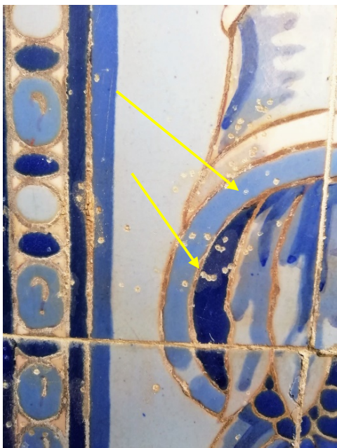
Daños en el vidriado por impactos
