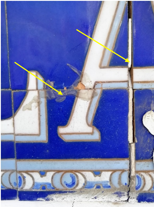
Excesiva junta y restos de adhesivo
