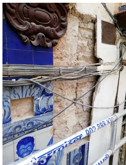
Desmontaje de azulejos con peligro de desprendimiento
