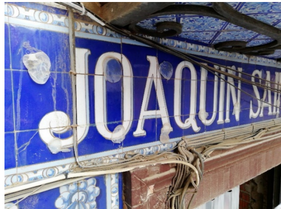
Puntos de silicona y cableado eléctrico
