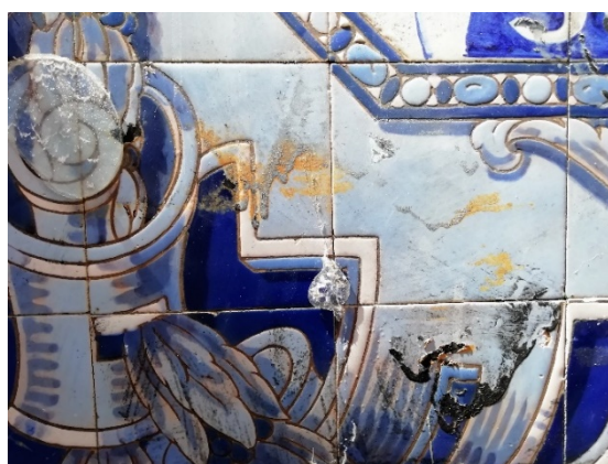
Suciedad, manchas de pintura y grafitis
