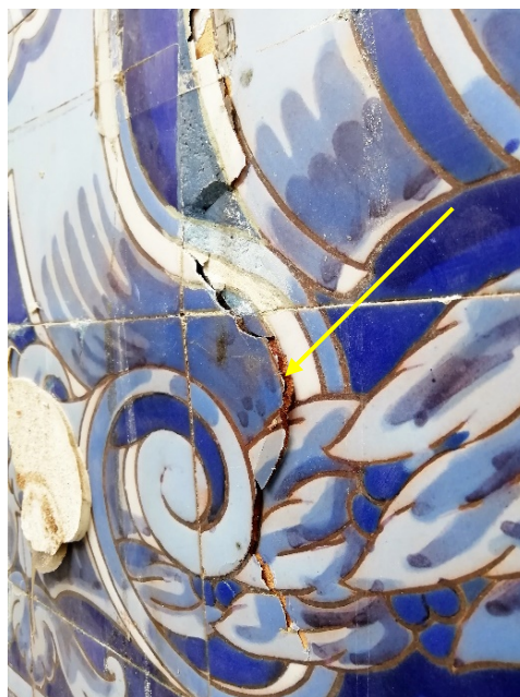
Abombamiento y levantamiento del vidriado
