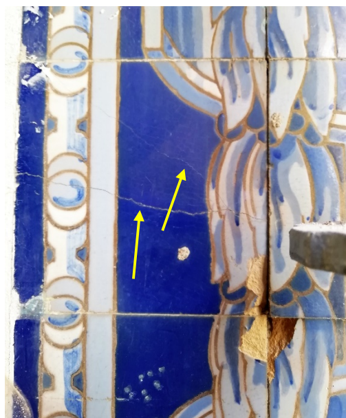
Grietas y fisuras. Perdida de pasta cerámica
