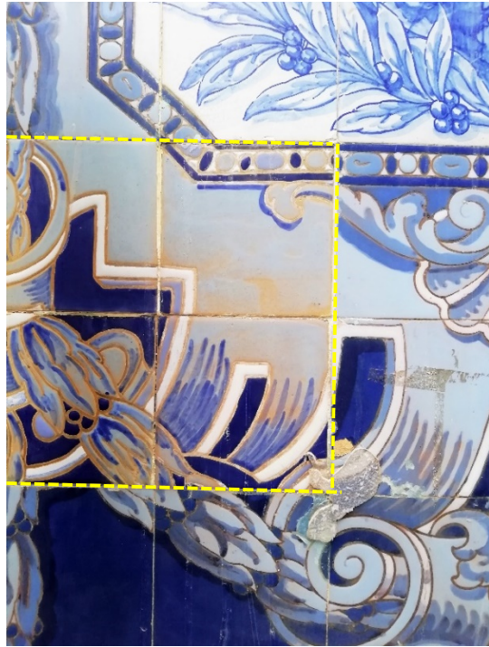
Azulejos de nueva factura de una intervención anterior.
