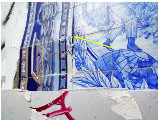
Zona abombada por pérdida de adhesión al soporte.
