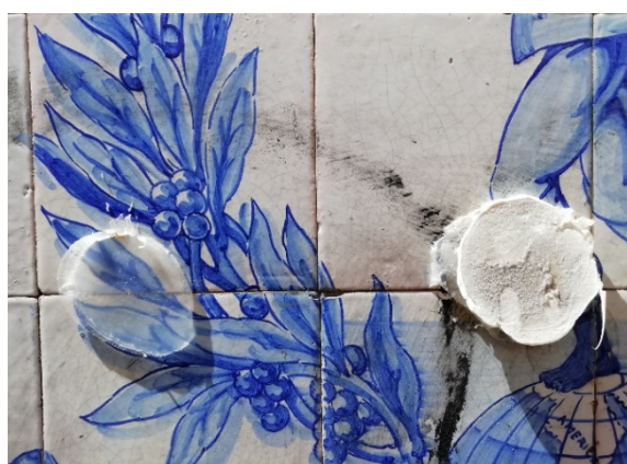
Suciedad superficial y puntos de silicona.
