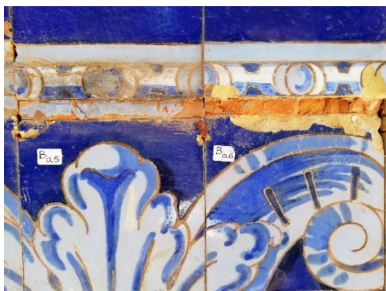
Deterioro producido por el anclaje de cables eléctricos
