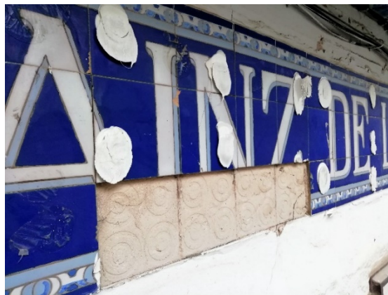
Desprendimiento de azulejos al retirar la protección
