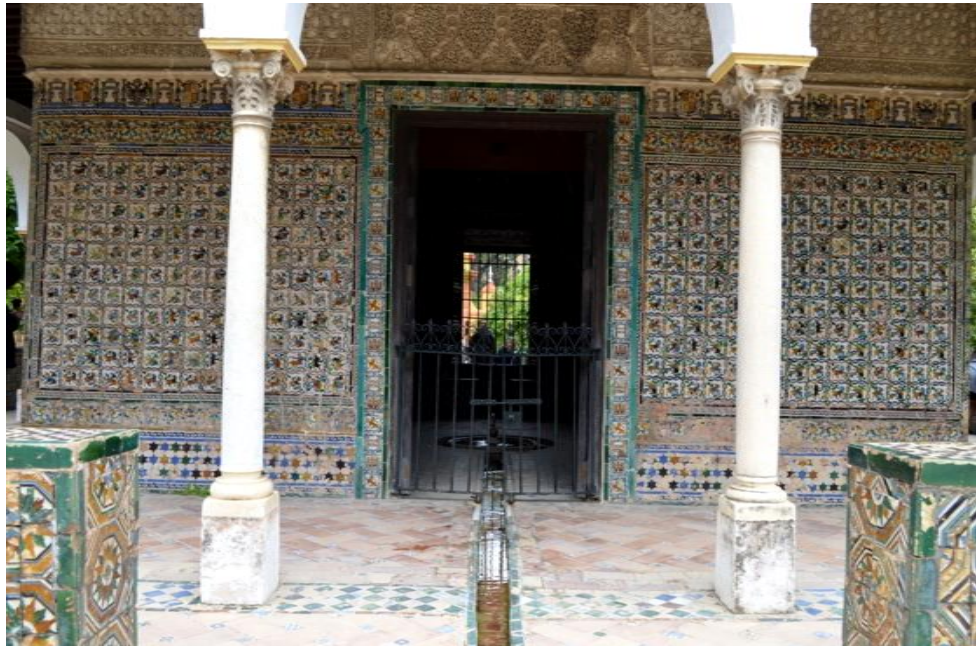
Fotografía nº 5 Vista exterior de los paramentos del alzado Sur. Se puede ver la composición de los paños cerámicos, la única puerta de entrada hacia el interior, las yeserías superiores con inscripciones árabes y las columnas de mármol blanco.
