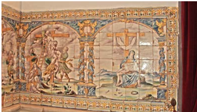
Fig. 13. Friso de azulejos del presbiterio de Zalamea, antes de la restauración.
