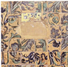
Estado en el que se hallaba el zócalo de azulejos: piezas perdidas y distribución aleatoria
