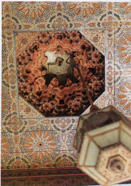
Deterioro actual de un alcófarabe.
